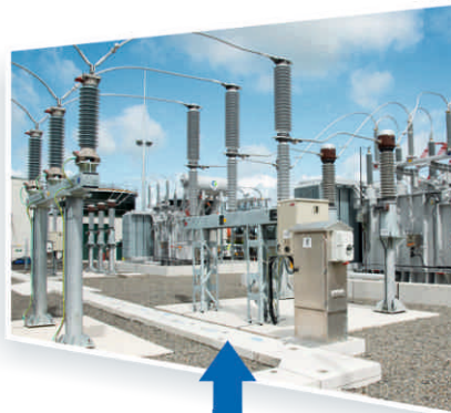
EHV Sub-Stations AIS/GIS
